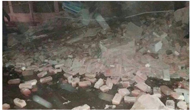
圖二 事故現場 部份建物磚牆倒塌
