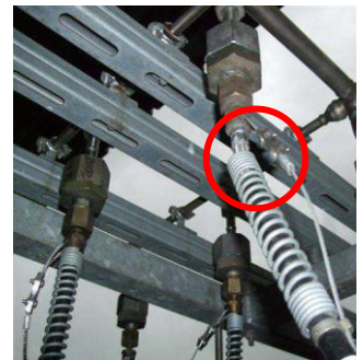
圖五、高壓灌裝軟管可有彎曲限制的彈簧。左彈簧安裝正確，右邊彈簧未確實安裝，造成上方脫落現象。
