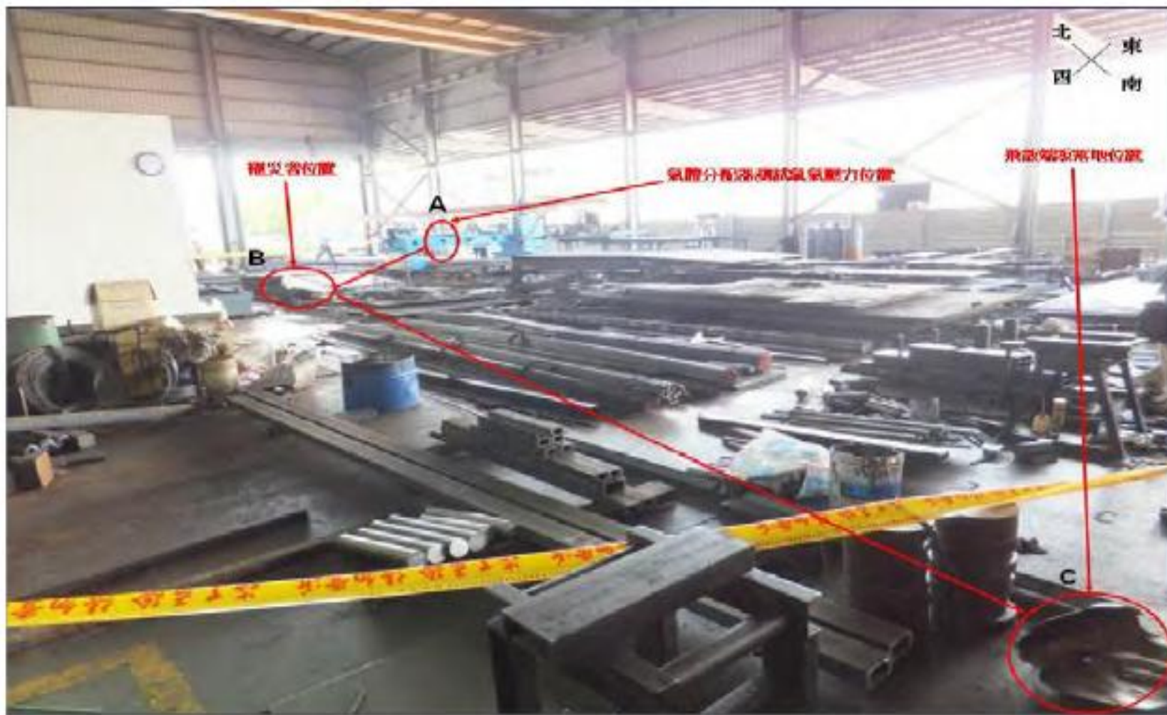
照片 2 肇災現場氣體分配器、罹災者與端板飛射路徑(示意圖)。
